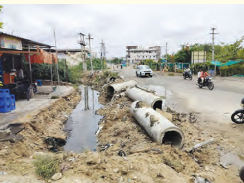
రోడ్డుపైన పారుతున్న మురుగునీరు
