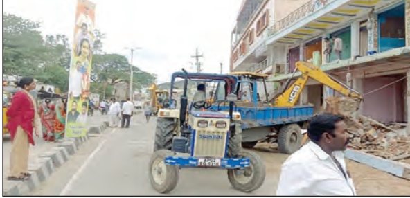
అక్రమ కట్టడ నిర్మాణాలను జెసిబి లతో తొలగిస్తున్న దృశ్యం
