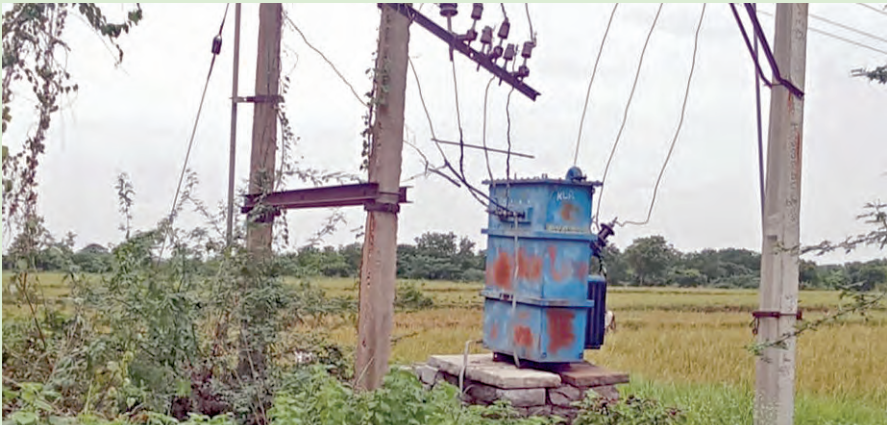
భూనాపూర్లో పనిచేయని ట్రాన్స్ఫార్మర్
