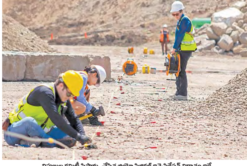
నిపుణుల కమిటీ నిర్మాణం చేసిన జియో ఫిజికల్ ఇన్వెస్టిగేషన్ విధానం ఇదే
