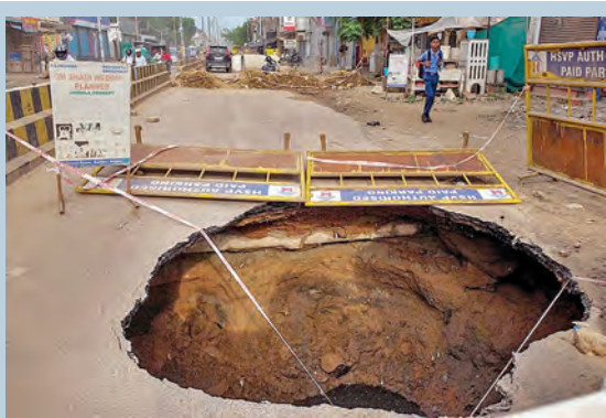
భారీ వర్షానికి సోమవారం గురుగ్రామిలో రహదారిపై ఏర్పడ్డ భారీ గుంత
