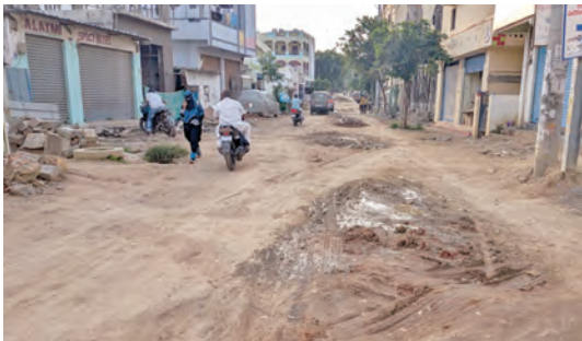
మేడ్చల్ పట్టణంలోని హౌసింగ్బోర్డు కాలనీ నుండి రైల్వే స్టేషన్ రోడ్లో డ్రైనేజీ నిర్మించి పరిశీలించడం వల్ల ఏర్పడిన గుంతలు
