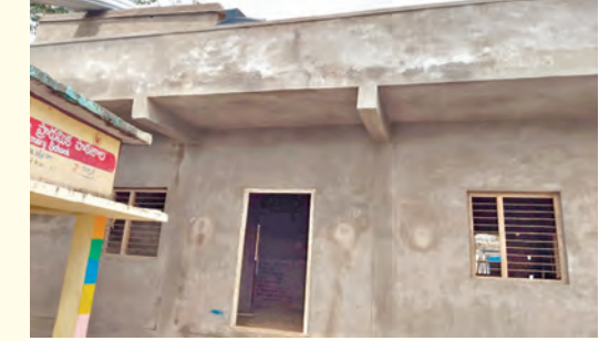
అసంపూర్ణంగా ఉన్న పంచాయతీ కార్యాలయ భవనం
